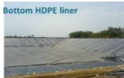
Fig. 9. Bottom HDPE Liner
